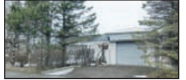
Fremristekkur - glæsilegt útsýni Einbýlishús á góðum útsýnisstað. Húsið er samtals 208 fm með innbyggðum bílskúr. Húsið er að mestu upprunalegt að innan og þarfnast endurnýjunar í takt við nýja tíma. Einnig þarfnast húsið að utan lagfæringar. Nýtt þak var sett á húsið hausti 1994. V. 45,0 m. 1340
