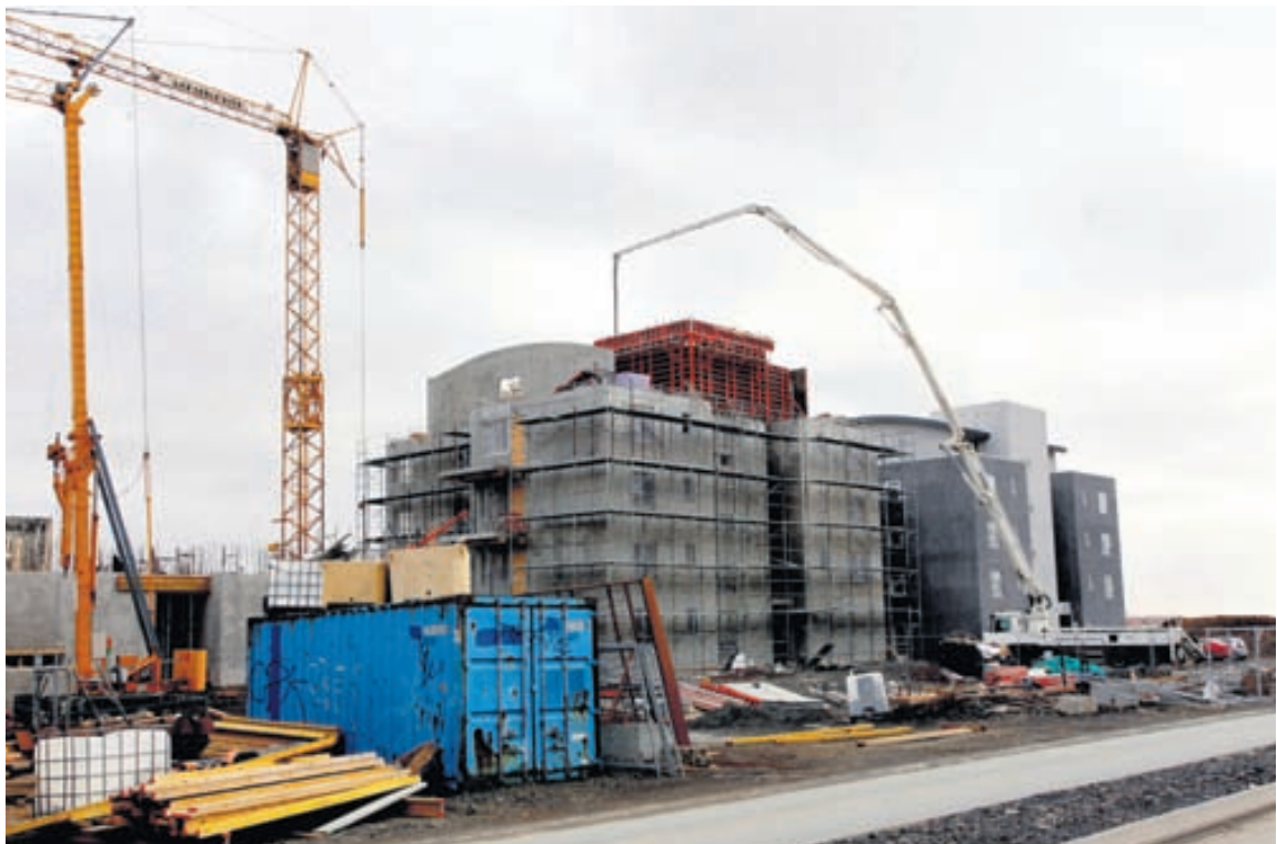
BYGGT Á NÝ Skyndilegur endir var bundinn á fyrirhugað íbúðahverfi í Úlfarsárdal þegar efnahagskreppan skall á árið 2008. Hjólin eru farin að snúast þar að nýju. FRÉTTABLAÐIÐ/PJETUR
