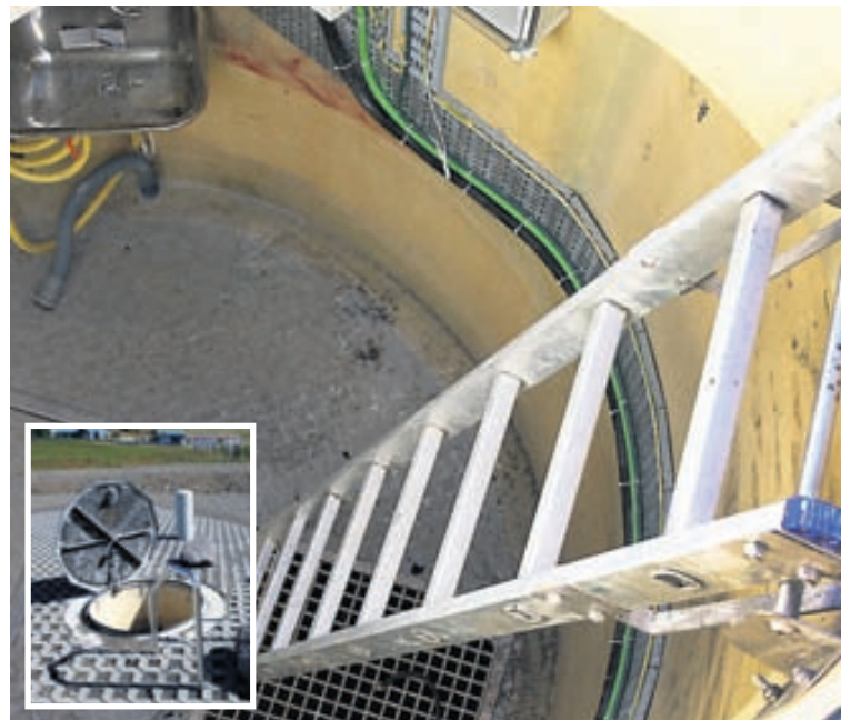
SLYSAHÆTTA Lokið á dælustöðinni er laust en tveimur stórum steinum hefur verið komið fyrir ofan á því. Lítið mál er að velja þeim af lokinu. Dælustöðin er skammt frá útikennslustofu og leikskóla.
