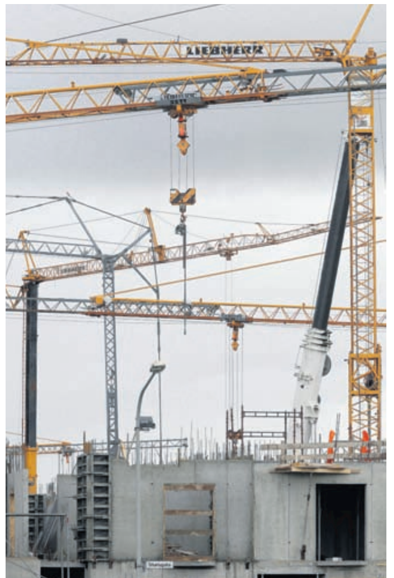
Fjórir kranar frá Örmum ehf. eru nú í Vatnsmýrinni þar sem nýir stúdentagarðar eru í byggingu.
