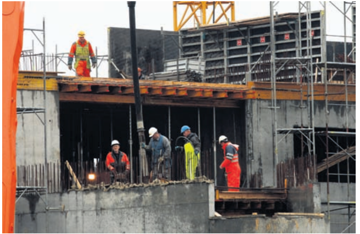
Í BYGGINGU Fjölmargir húsbýggjendur hafa sótt um undanþágu frá nýrri byggingarreglugerð, en frestur til að sækja um undanþágu rennur út um áramót. FRÉTTABLAÐIÐ/ANTON
