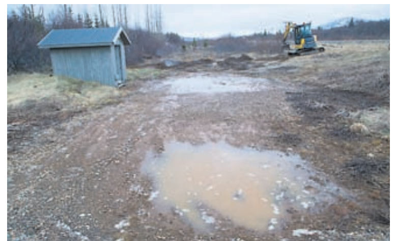
SKORRADAL Á SUNNUDAG Þúsundir lítra af 90 gráða heitu vatni láku út þegar heitavatnslögn í Skorradal fór í sundur á sunnudag. Þegar ljósmyndara Fréttablaðsins bar að garði var vatnið að mestu þornað.
