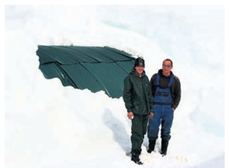
Á SVARTA KAFI Handmokað var ofan af sauðburðarskýlinu á Brúnastöðum sem var að falla saman undan snjófarginu. MYND/JÓHANNES RÍKHARDSSON
