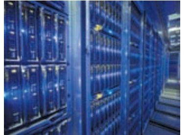
Í HAFNARFIRÐI Advania rekur gagnaverið Thor Data Center á Völlumum í Hafnarfirði.
