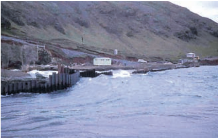
BROSTNAR VARNIR Þingvallavatn flæðir hér í gegnum rofið varnarþil og ofan í aðrennslisgöngin.
