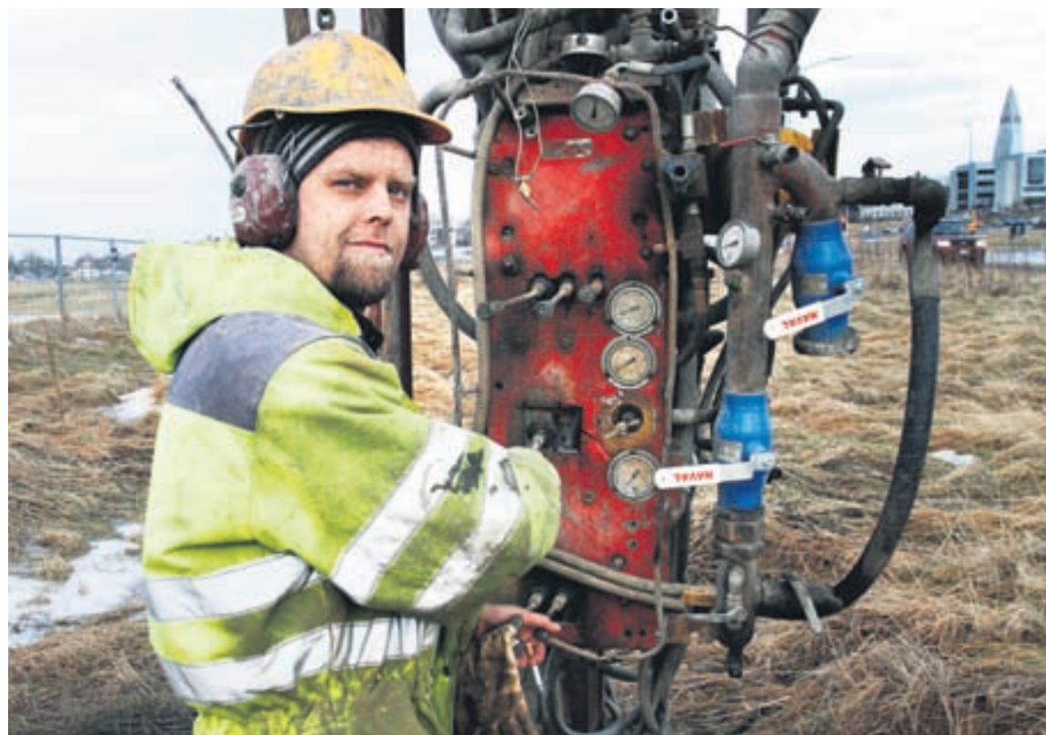
BORAR Í VATNSMÝRINNI Heiðar Már Hlökkversson, bormaður hjá Ræktunarsambandi Flóa og Skeiða, vinnur að grunnvatnsrannsóknum í Vatnsmýrinni. Boraðar eru níu holur og síritum komið fyrir til að fylgjast með grunnvatnssstöðunni. FRÉTTABLAÐIÐ/GVA
