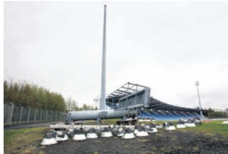
LAUGARDALSVÖLLUR Framkvæmdir við endurnýjun flóðlýsingar eru hafnar.
