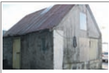
Bergstaðastræti 12 Húsið er á minjaskrá og því má ekki rífa það. Húsið er í mikilli niðurníslu.
