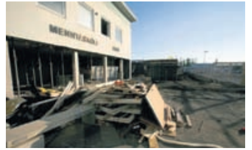
BYGGINGARSVÆÐI Lóð MS er undirlögð af drasli. FRÉTTABLAÐIÐ/ANDRI MARINÓ
