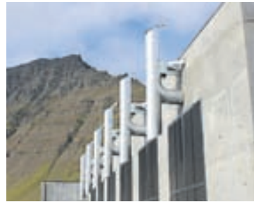
AUKIÐ ÖRYGGI Ný varaafsstöð Landsnets í Bolungarvík. MYND/LANDSNET
