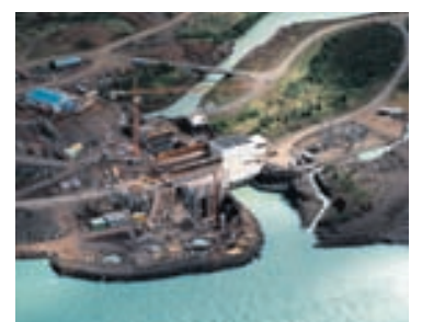
LAGARFOSSVIRKJUN RARIK rekur virkjun í Lagarfljóti. MYND/RARIK
