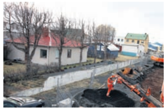
SPRENGT Í BAKGARÐ- INUM Hús Svanlaugar Rósar Ásgeirsdóttur er í sex metra fjarlægð frá þeim stað þar sem sprengt var fyrir bílakjallara fjölþýlishúss á Lýsisreitnum. FRÉTTA- BLAÐIÐ/GVA
