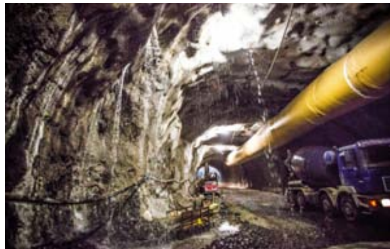
GÖNGIN Æð opnaðist í fyrra vestan megin í göngunum en vatnið er kaldara nú og straumurinn meiri. FRÉTTABLAÐIÐ/ÁRSSELL
