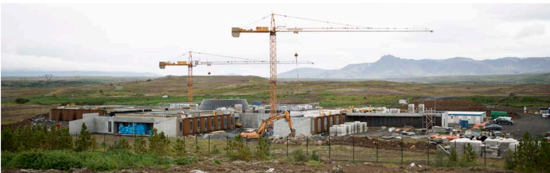
Framkvæmdir við fangelsið á Hólmsheiði eru langt á veg komnar. Búist er við að það verði tekið í notkun strax á nýju ári. Sérstök álma verður fyrir langtímavistun kvenna. Fréttablaðið/Ernir
