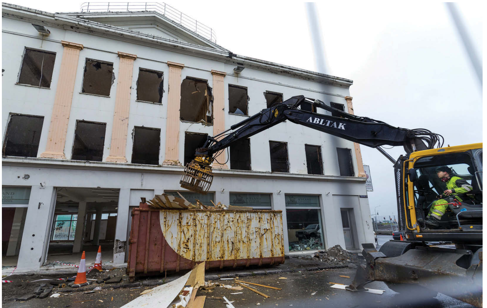
Unnið var við niðurrif á húsi á Hafnarstræti sem áður hósti verslun Rammagerðarinnar. Icelandair Hotels mun í framhaldinu reisa lúxushótel á reitnum. Fréttablaðið/Vilhelm
