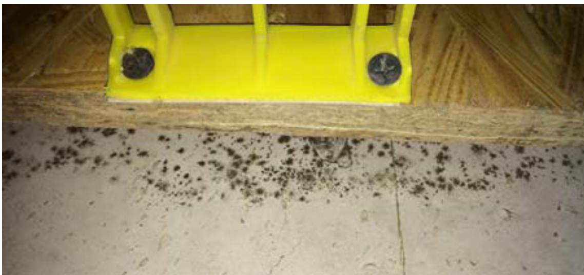
Mygla á steypum útvegg í nýlegu húsi einangruðu að innan.
