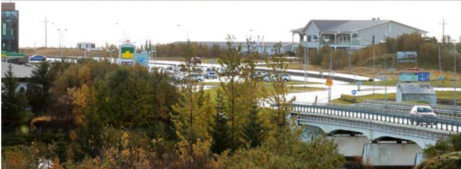
Fyrir og eftir Myndin til vinstri var tekin í fyrradag og sú til hægri í gær eftir að starfsmenn Landsnets hófu að taka niður gömlu loftlínuna milli Hellu og Hvolsvallar. Framkvæmdir á vegum Landsnets eru nú í fullum gangi og er áætlað að fyrsta áfanga verksins verði lokið fyrir helgi.
