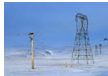
Uppbygging flutningskerfis raforku myndi bæta nýtingu. FRÉTTABLAÐIÐ/VILHELM
