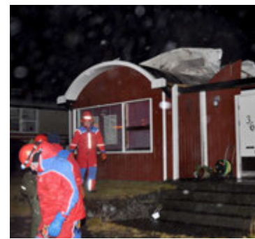
Þak fæk af Sunhouse-húsi 9. október 2009. Það hús var mun neðar í bænum en það sem skemmdist í veðrinu 7. desember. FRÉTTABLAÐIÐ/ÓSKAR
