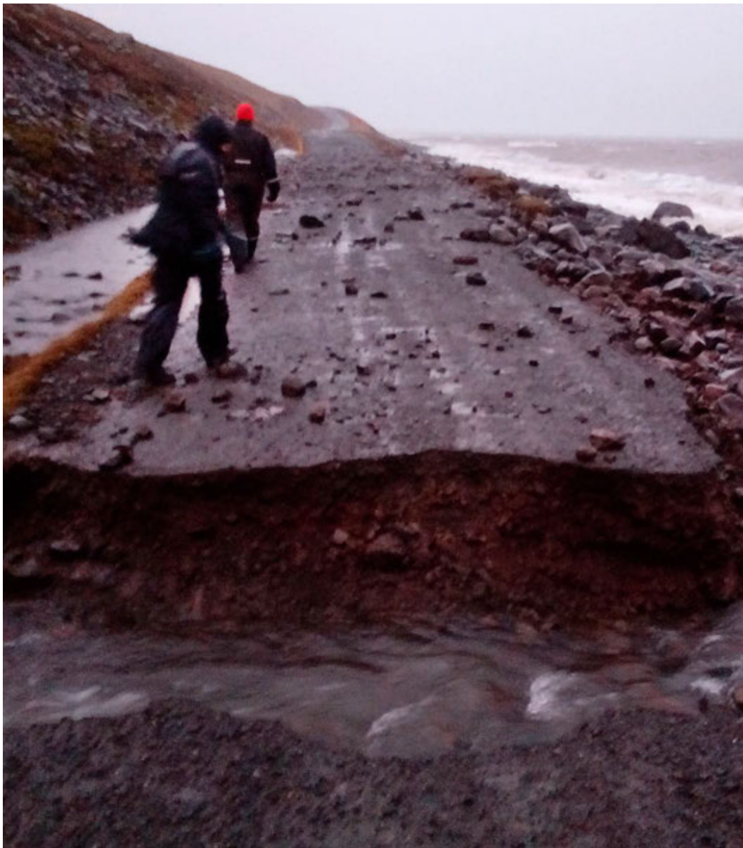
Vegur við Eskifjörð rofnaði vegna sjóbrots. MYND/FRÍÐBERGUR HREGGVIÐSSON
