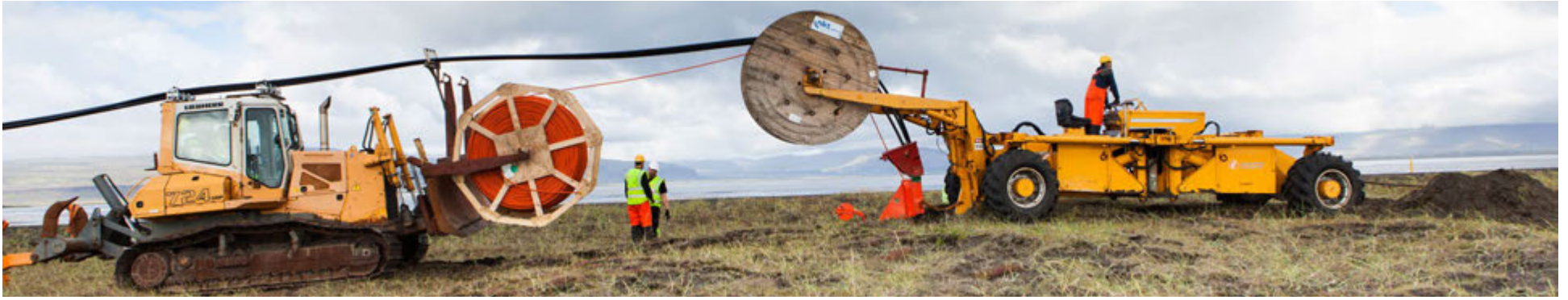
Á þessari mynd sést hvernig allir strengirnir renna yfir jarðýtuna í jöfnu átaki og ofan í rennuna aftan á köngulóinni en fjarskiptarörið er þarna framan á ýtunni og fer sömu leið og strengirnir.
