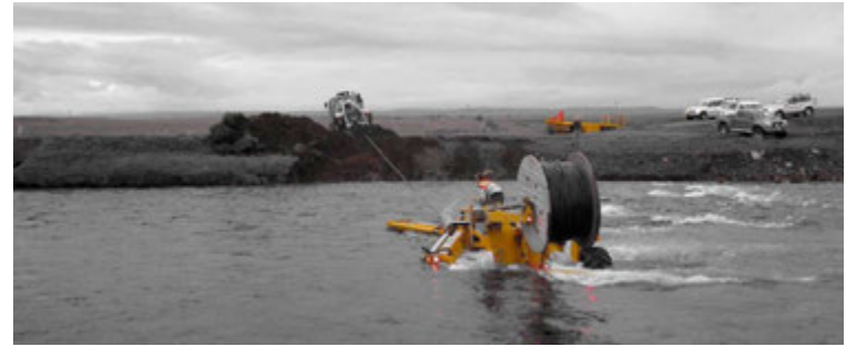
Köngulóin fer yfir Brúará og plægir í móbergsbotn. Verkefnið var unnið fyrir RARIK en engir aðrir plógar eða vinnuvélar gátu unnið verkið.
