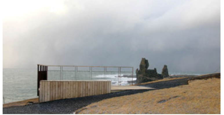
Að undanförunu hafa verið sett upp fræðsluskilti, byggðir upp göngustígar og útsýnis- og öryggispallar á völdum stöðum í þjóðgarðinum meðal annars á Svalþúfu, Lónrangar fjær.
