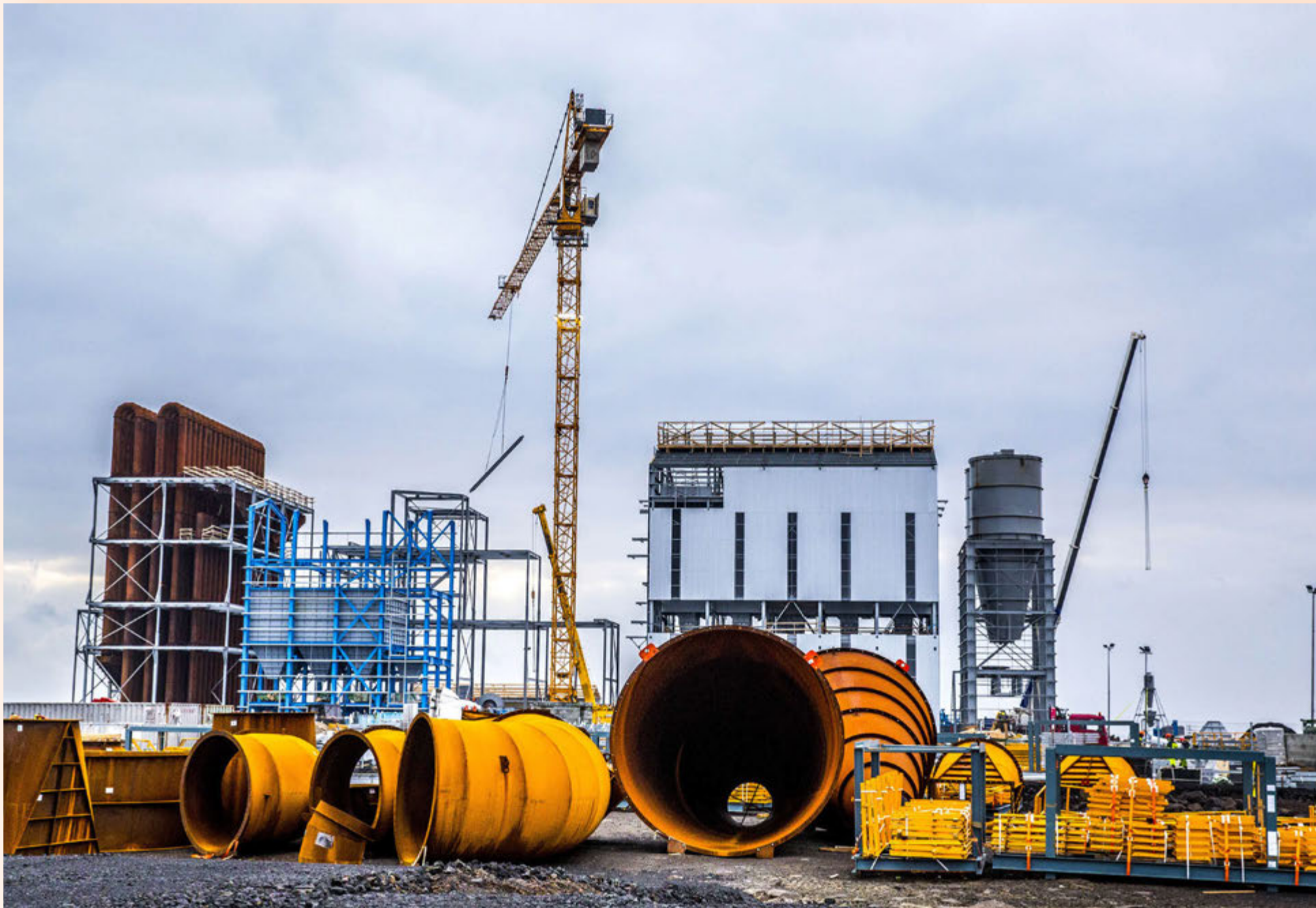
Búist er við að kísilver United Silicon í Helguvík muni taka til starfa á þessu ári en framkvæmdir eru í gangi. Reykjanesbær hefur lagt milljarða í rekstur Reykjaneshafnar sem er í greiðslustöðvun. FRÉTTABLAÐID/VILHELM
