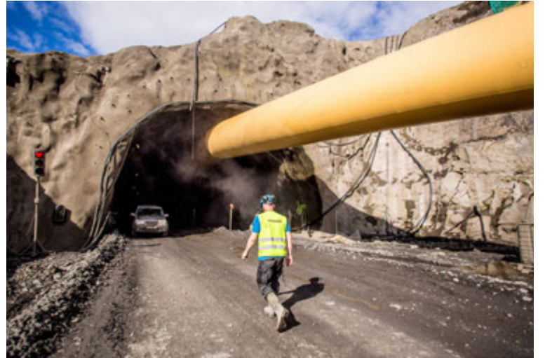
Hagstætt er að flytja efnið úr göngunum í flughlað en ríkið setur ekki fé í það. FRÉTTABLAÐIÐ/AUÐUNN
