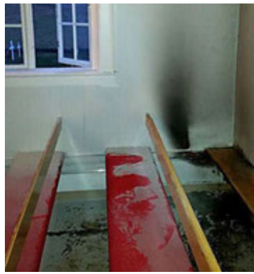
Töluverðar sótskemmdir urðu af völdum brunans. MYND/BOLLI
