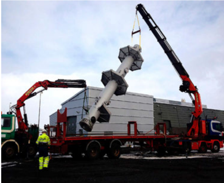
Mannvit hafði yfirumsjón með og samræmdi hönnun, sá um eftirlit með smíði og uppsetningu og annaðist uppkeyrslu lofthreinsistöðvar ON á Hellisheiði.
