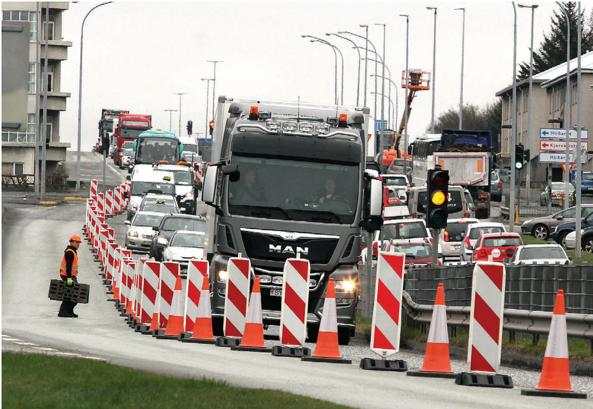
Framkvæmdir við Miklubraut vegna gerðar göngu- og hjólastígs hófust í dag, en gera má ráð fyrir umferðartöfum fram í ágúst og verða ökumenn og vegfarendur að sýna þolinmæði vegna þessa. Akreinum til vesturs var fækkað tímabundið í morgun frá Lönguhlíð að Rauðarárstíg. En það eru framkvæmdir víðar í Reykjavík. FRÉTTABLAÐIÐ/GVA sjá síðu 8.
