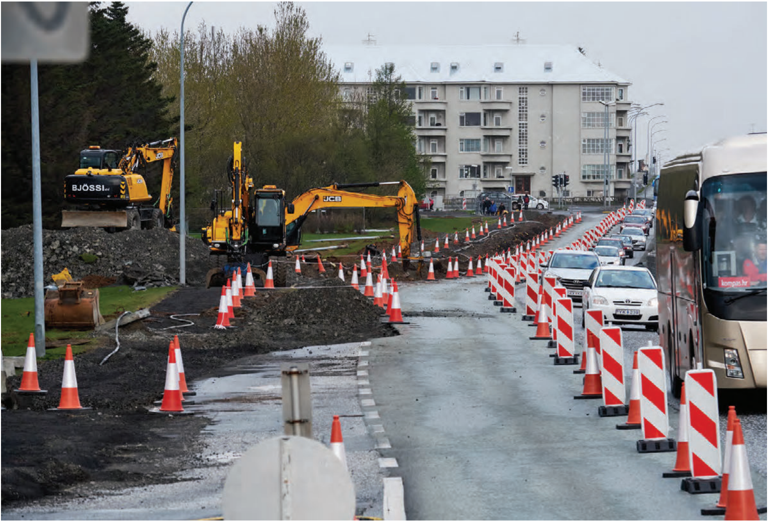
„Þetta er stórskrýtið. Ég keyrði þarna líka á föstudaginn og það var ekki einn maður sjáanlegur,“ segir Áslog Friðriksdóttir, borgarfulltrúi Sjálfstæðisflokksins. Ekkert var unnið við framkvæmdir á Miklubraut í gær og stóðu vinnuvélar mannlásar. Einni akrein hefur verið lokað og er gert ráð fyrir að loka fleiri akreinum í sumar. Áslog bendir á að framkvæmdir í borginni kunni að valda miklum vandræðum. FRÉTTABLAÐIÐ/ANTON BRINK
