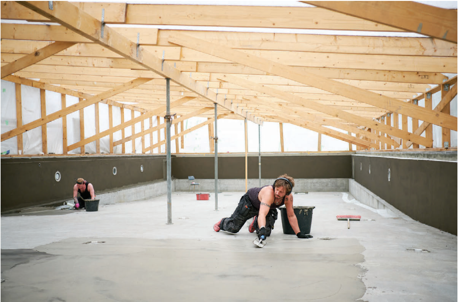
Framkvæmdir við Sundhöll Reykjavíkur eru nú í fullum gangi og þegar Fréttablaðið leit þar við í gær var verið að múra, slétta og gera fint. Gert er ráð fyrir að framkvæmdir kosti aðeins yfir milljarð króna en viðbyggingin verður um 1.140 fermetrar og útisundlaugin er um 750 fermetrar. Viðbygging er byggð eftir vinningstillögu VA Arkitekta ehf. í kjölfar hönnunarsamkeppni sem haldin var árið 2013. FRÉTTABLAÐIÐ/ANTON BRINK
