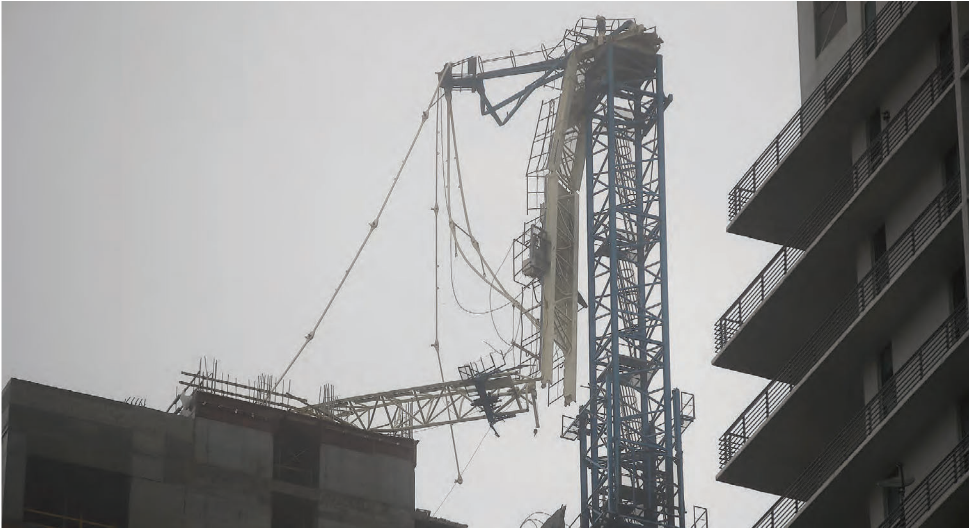
Svo öflugur var stormurinn í Miami í gær að byggingarkranar brotnuðu. NORDICPHOTOS/GETTY
