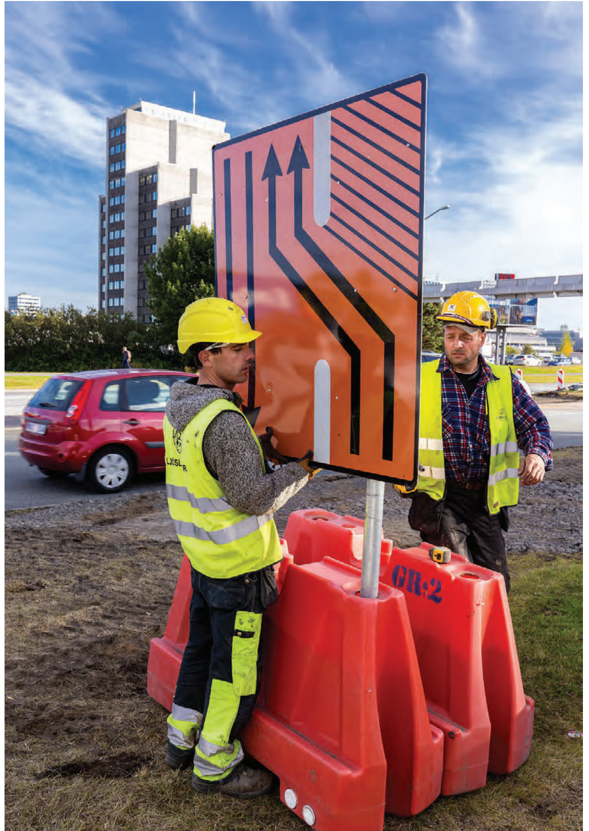
Martröð í uppsiglingu Í dag hefst endurnýjun stofnlagnar fyrir kalt vatn yfir Kringlumýrarbraut ofan við Miklubraut. Búist er við mjög miklum tófum á umferð næstu tvær vikurnar því akreinum á Kringlumýrarbraut á þessum stað verður fækkað í aðeins tvær í hvora átt á meðan framkvæmdirnar ganga yfir. FRÉTTABLAÐIÐ/VILHELM
