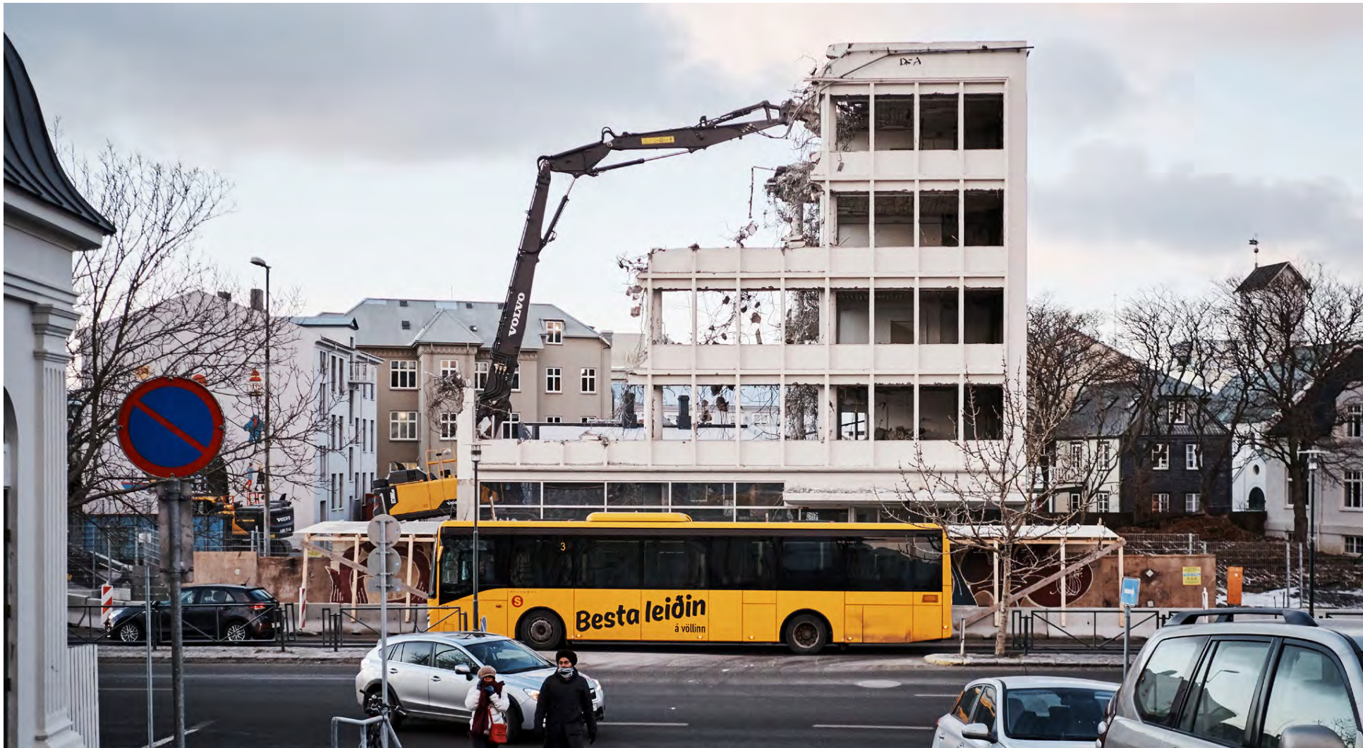
Niðurrif gamla Iðnaðarbankahússins við Lækjargötu 12 í miðborginni, sem reis á árunum 1959 til 1963 og hýsti síðast starfsemi Íslandsbanka, er nú í fullum gangi. Verkið hófst um miðjan októbermánuð og er nú rúmlega hálfnað. Götumyndin þar hefur strax breyst talsvert en til stendur að byggja nokkurra hæða hótél á lóðinni á komandi árum. FRÉTTABLAÐIÐ/ANTON BRINK
