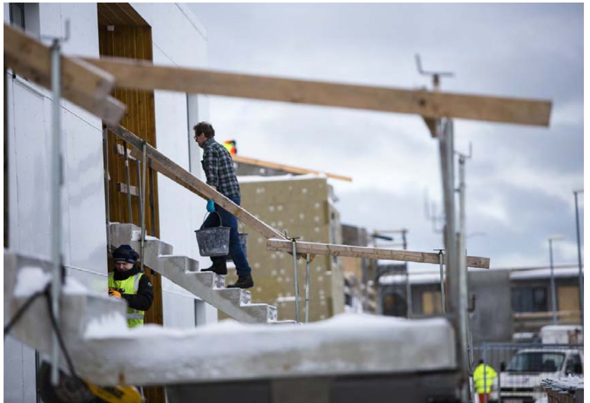
Íðnaðarmenn voru að störfum í nýbyggingu er ljósmyndari Fréttablaðsins heimsótti Akranes í gær. FRÉTTABLAÐIÐ/ERNIR
