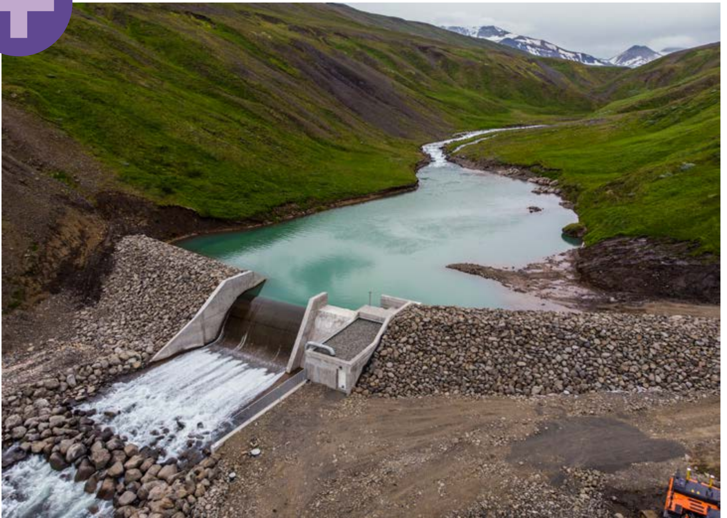
Framkvæmdin felst í því að stífla Glerá inni í Glerárdalnum og leiða vatnið eftir um sex kílómetra langri niðurgrafinni þrýstípu að stöðvarhúsi í Réttarhvammi. FRÉTTABLAÐIÐ/AUDUNN
