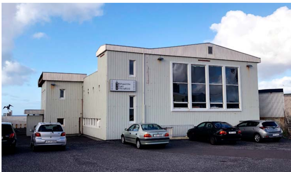
Ysta byrði hússins er í slæmu ástandi en um timburklæðingu er að ræða að stærstu leyti. Undir henni leynist þó upprunalega húsið frá 1944.
