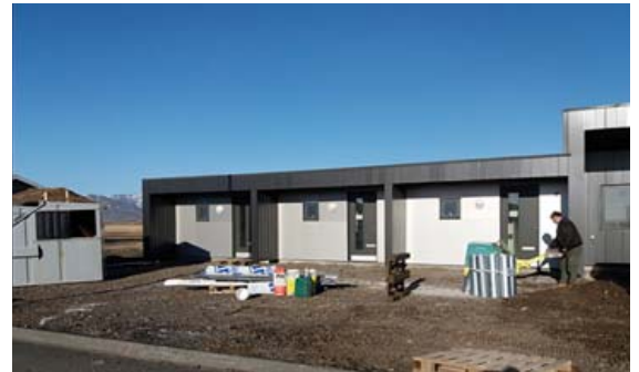
Á síðasta ári voru byggðar sex smábúðir með einingahúsum á Höfn í Hornafirði. Verkefnið tók þrjá mánuði.
