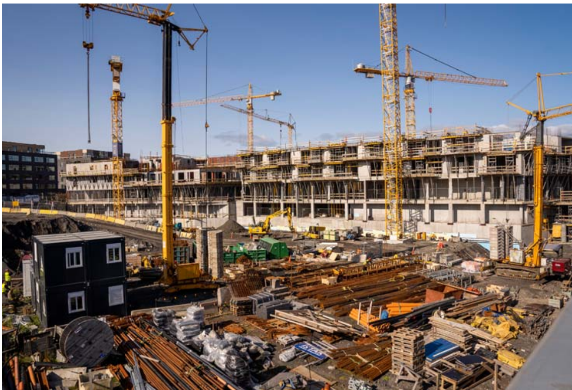
Frankvæmdir við Hafnartorg eru í fullum gangi og eru einar þær umfangsmestu í miðbænum. Sjö byggingar rísa á reitnum og verður heildarstærð um 24 þúsund fermetrar. Alls verða 76 lúxusíbúðir á svæðinu auk skrifstofu- og verslunarrýmis. Áætluð verklok eru á næsta ári. FRÉTTABLAÐIÐ/EYÞÓR
