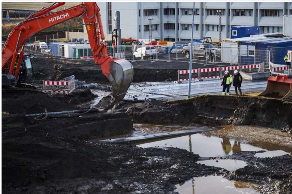
Kaldavatsnlaust varð við á Vesturbæ Reykjavíkur eftir að verktakar á Landspítalalóðinni við Hringbraut grófu í stofnlögn eftir hádegi í gær. Eins og gefur að skilja flæddi mikið vatn á svæðinu sem olli þrýstingslækkun í dreifikerfi kalda vatnsins vestur í borg. Verkamenn voru á fullu við að deila upp og veita vatninu annað þegar ljósmyndara Fréttablaðsins bar að garði. Sannkallað háflóð við Hringbraut. FRÉTTABLAÐIÐ/ANTON BRINK
