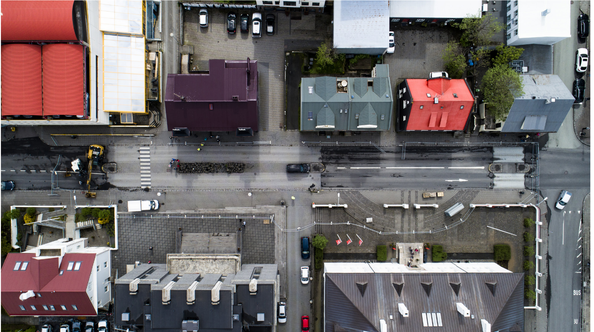
Hverfisgötu hefur nú verið lokað vegna framkvæmda en meðal annars er verið að endurgera götuna á milli Ingólfsstrætis og Smiðjustígs. Áætlað er að verkinu ljúki í september og má því búast við að vegfarendur þurfi að aka hjáleirðir að minnsta kosti næstu mánuðina. Hið sama gildir um Strætó en leiðir 1, 6, 11, 12, 13 og 14 aka um Sæbrautina. FRÉTTABLAÐIÐ/ERNIR
