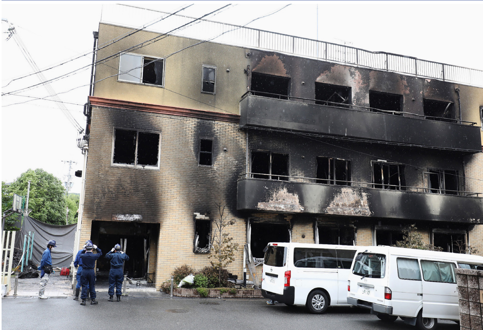
Lögreglan í japönsku borginni Kyoto rannsakaði í gær framleiðsluhús teiknimyndafremleiðslufyrirtækisins Kyoto Animations sem brann á fimmtudag. Lögreglu grunar að 41 árs gamall karlmaður sem sakaði fyrirtækið um ritstuld hafi kveikt í byggingunni og drepið 33 starfsmenn. NORDICPHOTOS/AFP
