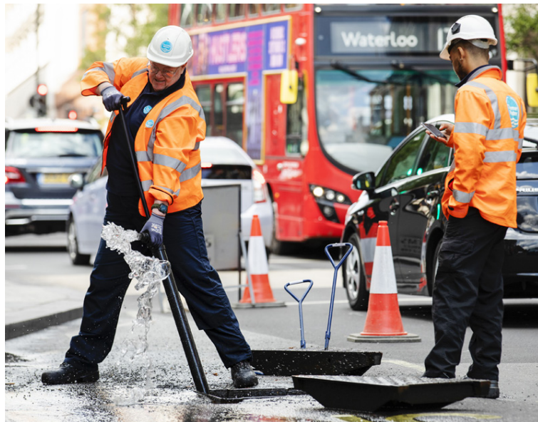
Starfsmenn Thames-vatnsveitunnar, sem er stærsta vatnsveita Bretlands, dæla vatni úr holræsi á Oxfordstræti í Lundúnum í gær.
