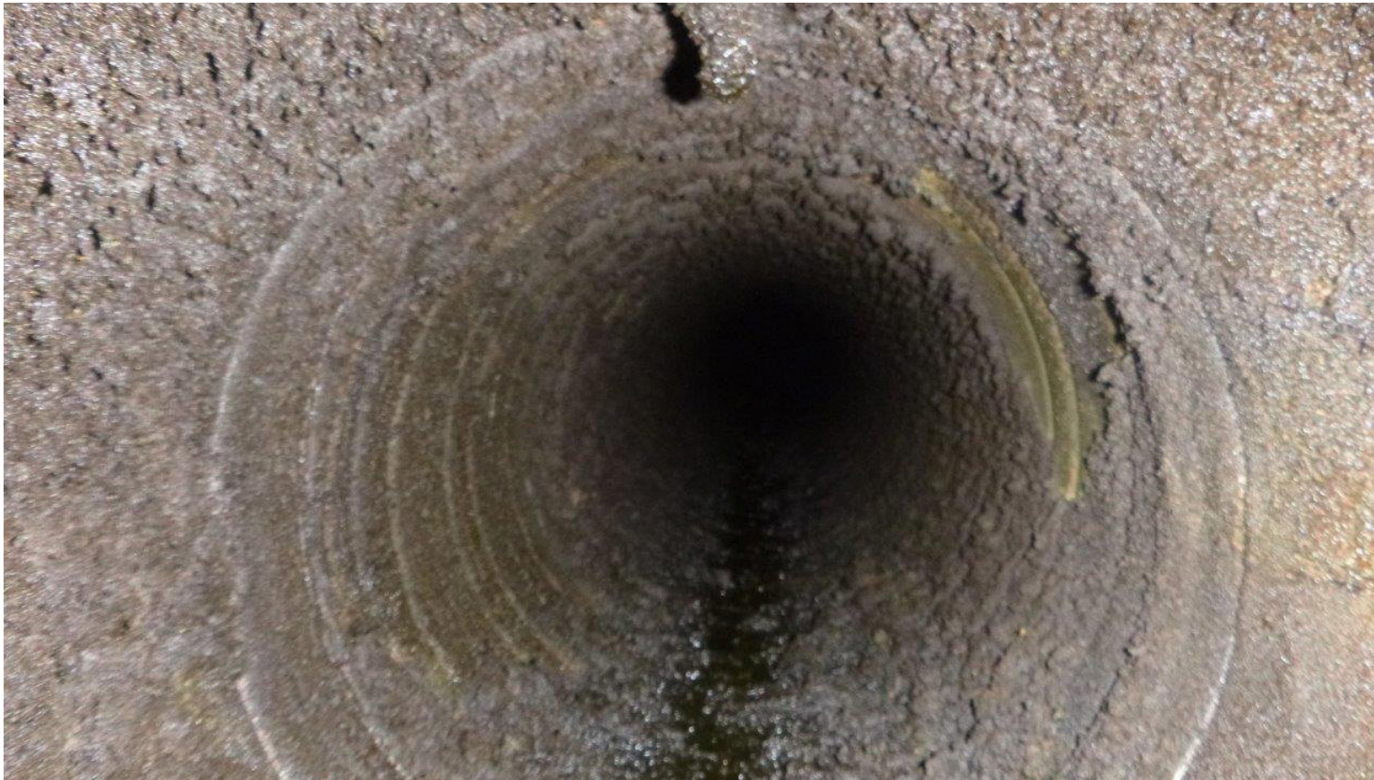
Hér sést hvernig mikil óhreinindi hafa tekið sér bólfestu í lofstokki sem var tengdur eldhúsi. Ef þetta er ekki þrifið getur þetta verið heilsuspillandi.
