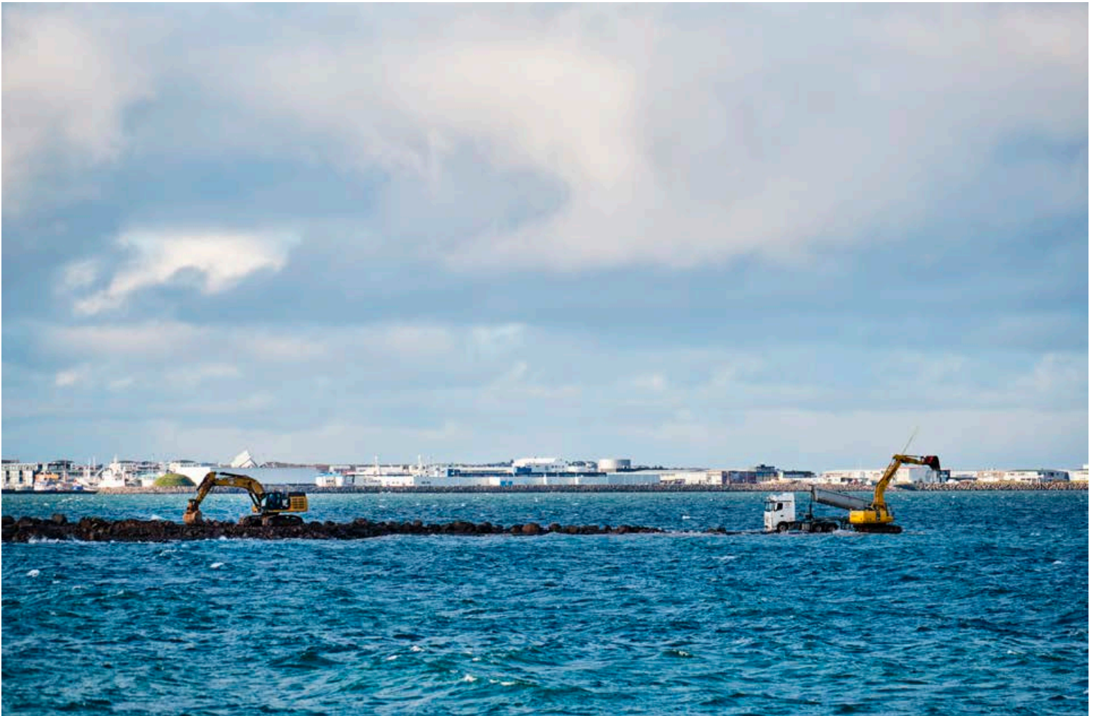
Unnið að landfyllingu sunnan Skarfaskers /Skarfabakka í Reykjavík. Alls fara 300.000 rúmmetrar af jarðvegi byggingarsvæðis Landspítalans við Hringbraut til landfyllingar samkvæmt aðalskipulagi Reykjavíkur. Það er 2,5-3 hektara stækkun svæðis Sundahafnar. FRÉTTABLAÐIÐ / ANTON BRINK
