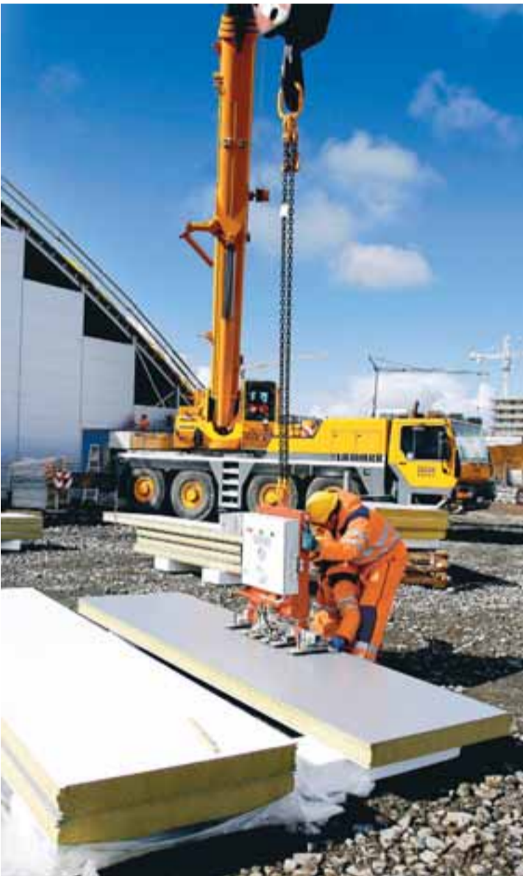
Unnið er við að klæða höllina með samlokueiningum. 80 tonna Liebherr-krani frá Ístaki sér um að lyfta þeim á réttan stað og á enda hans er sogklukka sem tveir menn eru fljótir að festa einingarnar á.
