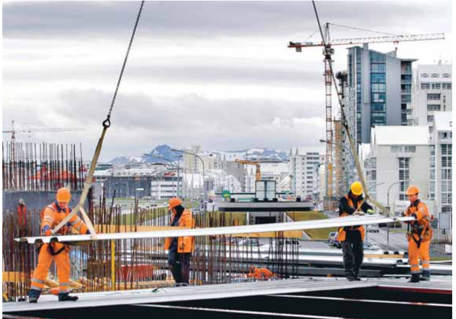
UNNIÐ AF KAPPI Mikill gangur er í byggingu tónlistarhússins á hafnarbakkanum í Reykjavík. Mannfrekar framkvæmdir eru fram undan, enda þótt útlendingar flykkist heim í auknum mæli.
