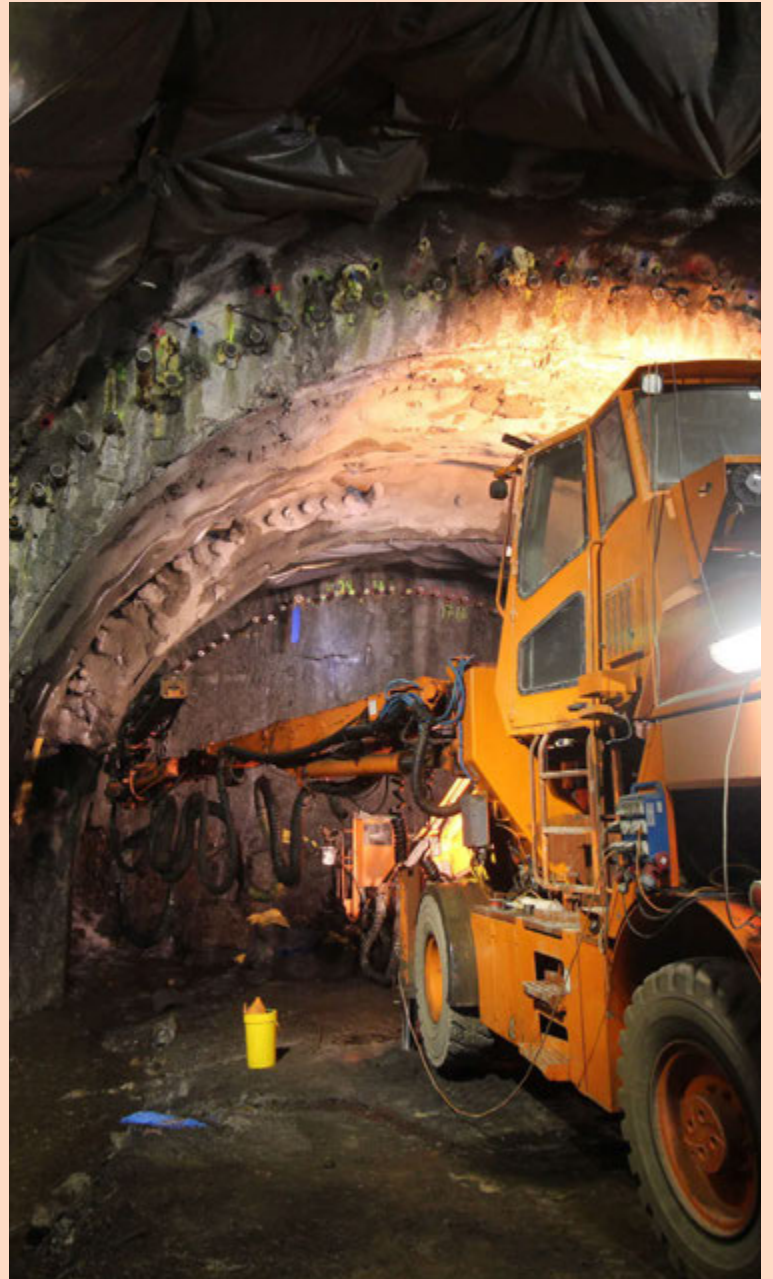
Einungis á eftir að grafa 441 metra í Vaðlaheiðargöngum. Samkvæmt upphaflegri áætlun áttu þau að opna fyrir umferð í desember síðastliðnum. FRÉTTABLAÐIÐ/AUÐUNN
